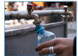
Brauchwasserdesinfektion im Katastrophenfall, z.B. Hochwasser
